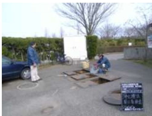
一般施設の維持管理 (浄化槽法定検査状況)
